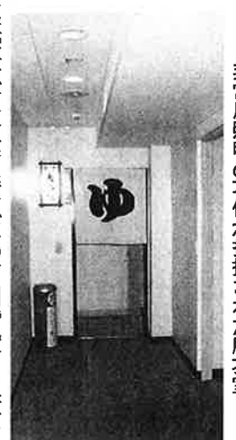
非常用照明の不備が指摘された脱衣室
